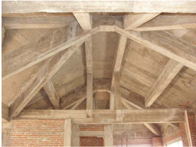
รูปที่ 6 แสดงการทำคานปรับความลาดชันให้สอดคล้องกับมุมหลังคา เพื่อยกระดับฝ้าเพดานได้ตามที่แบบกำหนด
