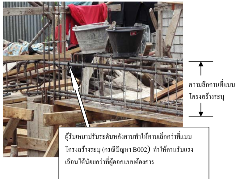
รูปที่ 2 แสดงการจัดวางเหล็กคานผิดจากแบบโครงสร้าง
