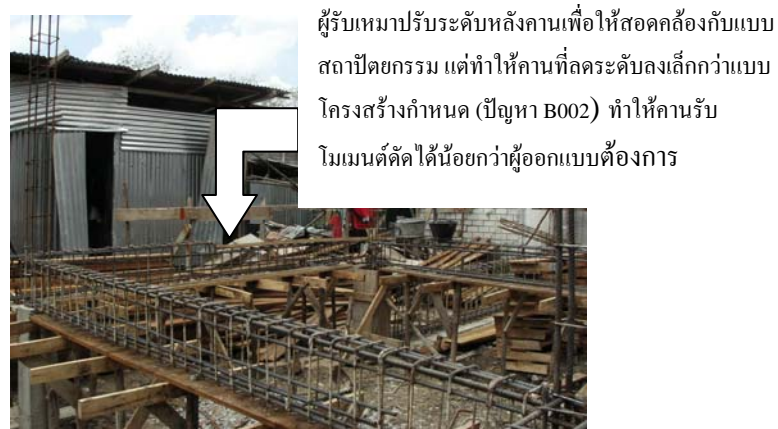
รูปที่ 3 การจัดวางเหล็กเสริมคาน เล็กกว่าที่แบบโครงสร้างระบุ
